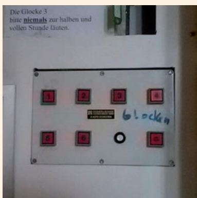
Blick in den Schaltkasten / Foto: Regina Voß
